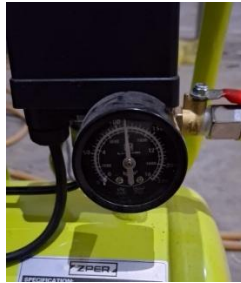
Gambar 4. 3 Indikator Bar Meter Kompresor Sumber: Dokumentasi Pribadi 2026
