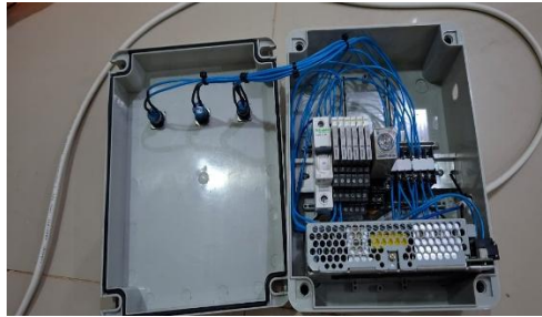
Gambar 3.35 Panel Box Sistem Elektrikal
