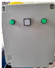
Gambar 3. 27 Control Box Sumber: Dokumentasi Pribadi 2026
