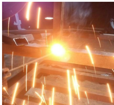
Gambar 3. 40 Proses Pengelasan Full Sumber: Dokumentasi Pribadi 2026
